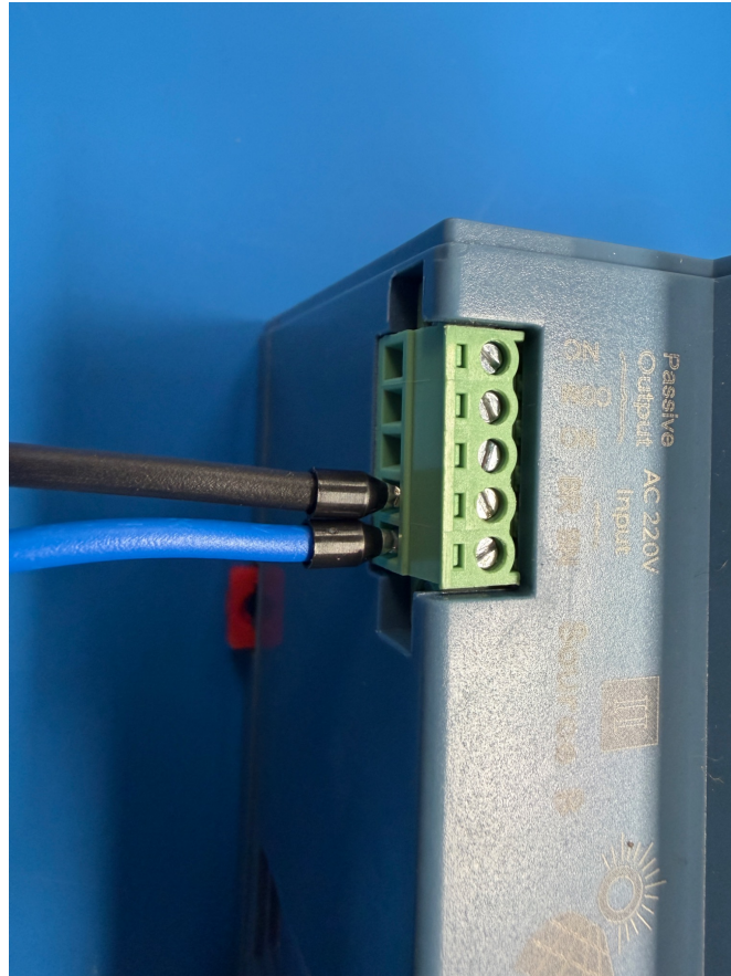
Bild 7 – Detailansicht der Überwachungsklemmen BR / BN
